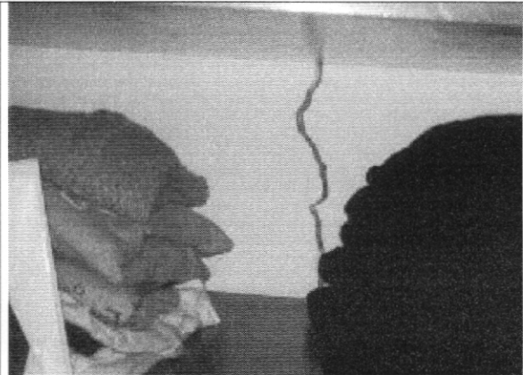
Foto 8. Muros en mal estado, costado sur
