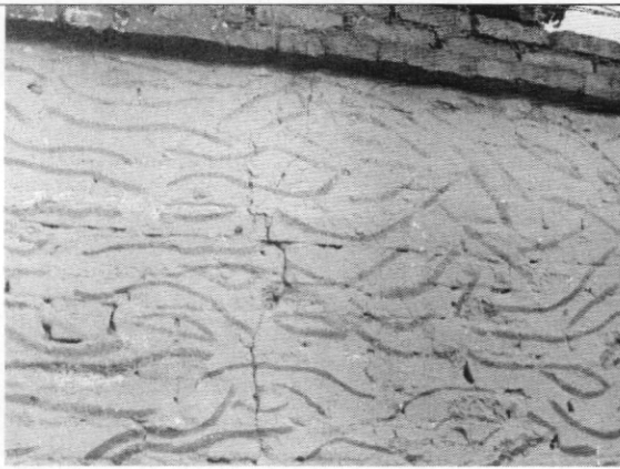
Foto 7. Agrietamiento vertical del muro en el extremo sur
