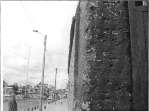
Foto 3. Pérdida de verticalidad evidente
