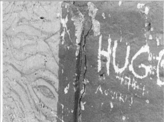
Foto 6. Agrietamiento vertical entre muro y mocheta
