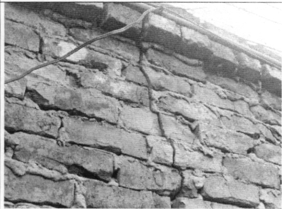
Foto 8. Agrietamiento en la cara interna del muro
