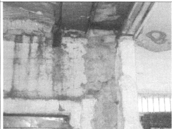
Foto 6. Humedad y deterioro en la parte superior del muro
