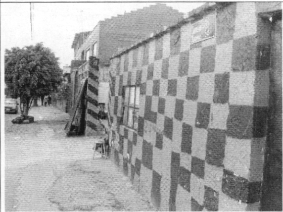
Foto 6. Aspecto del muro de cerramiento del costado occidental al momento de la visita
