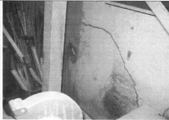
Foto 5. Fractura en muro costado occidental, local extremo sur
