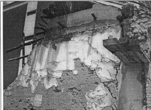
Foto 3. Muros internos agrietados
