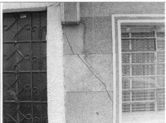
Foto 2. Agrietamiento diagonal en muro de fachada
