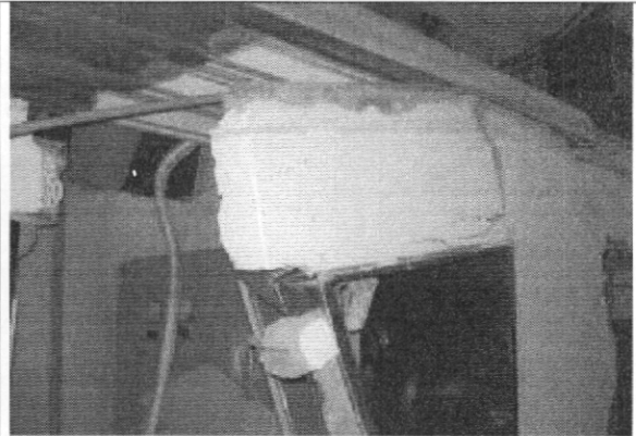
Foto 2. Muros primer piso, colapso parcial
