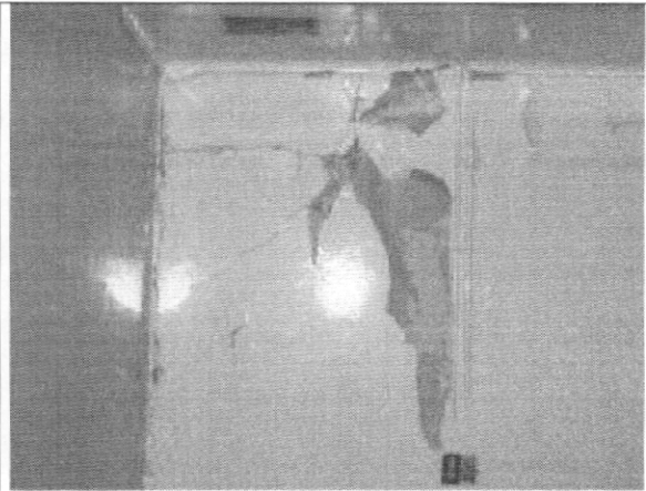
Foto 8. Muros en mal estado, segundo piso
