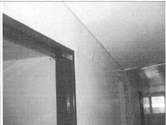
Foto 10. Grietas en muros de tercer piso
