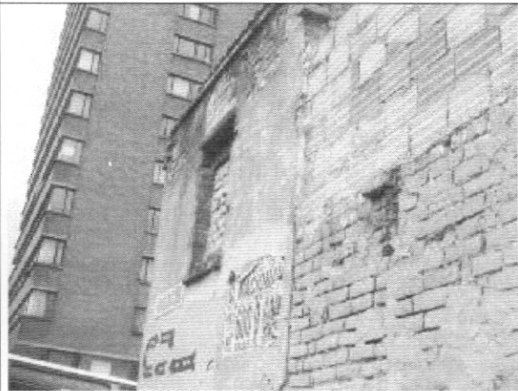
Foto 10. Leve pérdida de verticalidad en muro construcción de dos niveles
