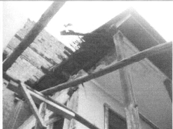
Foto 6. Desprendimiento de cubierta en zona posterior.
