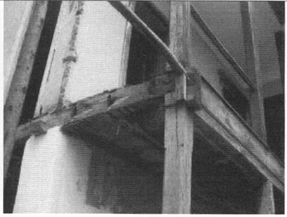
Foto 4. Desprendimiento de elementos de madera del entrepiso en parte posterior.
