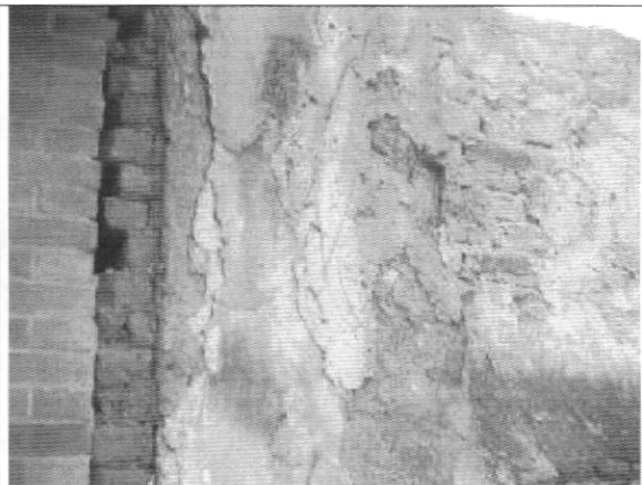
Foto 6. Agrietamiento parte superior muro costado sur
