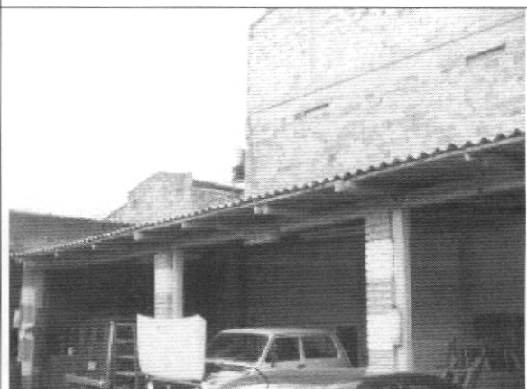
Foto 8. Cobertizo parte posterior inmueble.
