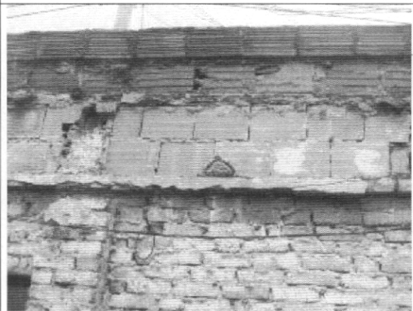
Foto 6. Bloque de arcilla en malas condiciones, parte superior
