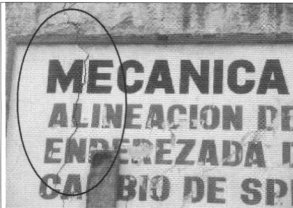
Foto 3. Grieta en parte superior del muro de fachada
