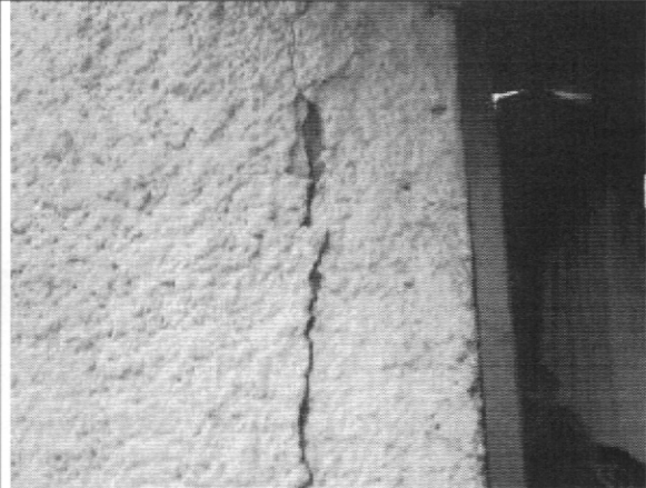
Foto 4. Grieta en muro de fachada.
