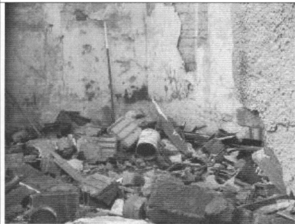
Foto 6. Colapso de cubierta
