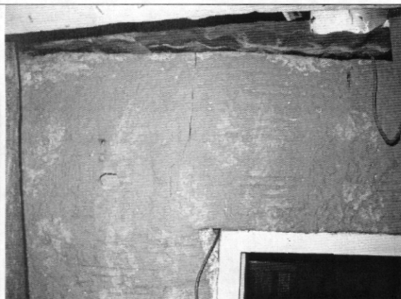
Foto 7. Grietas en muro de entrada al sector posterior
