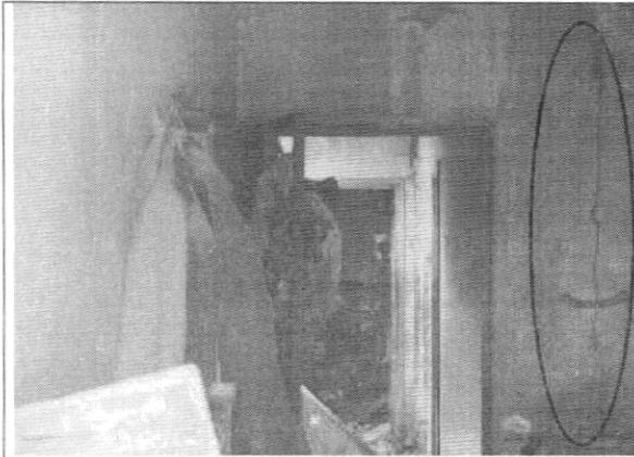
Foto 3. Agrietamientos en muros internos.
