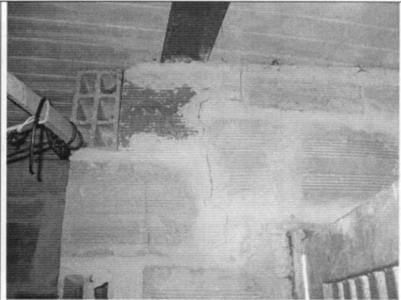
Foto 10. Fisura y piezas de mampostería sueltas
