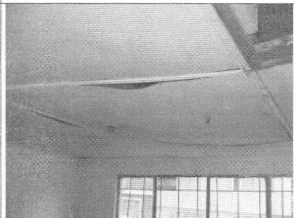
Foto 8. Deflexiones y desprendimiento de cielo raso mezanine.
