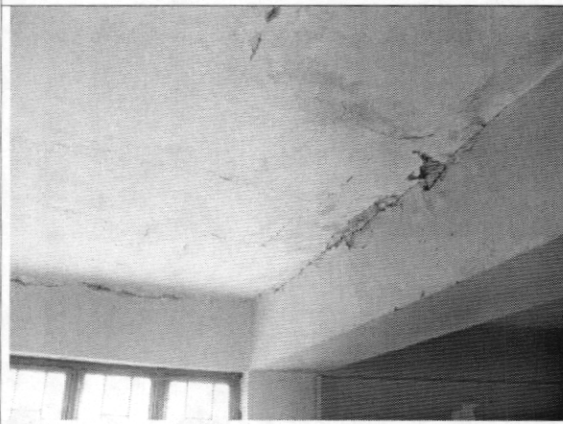
Foto 3. Humedades y desprendimiento de acabados en cielo raso
