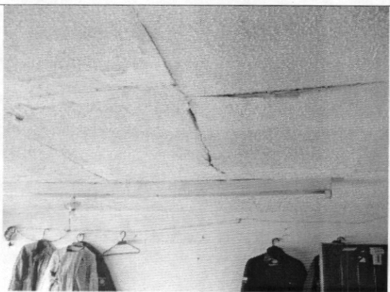
Foto 9. Deterioro del cielo raso
