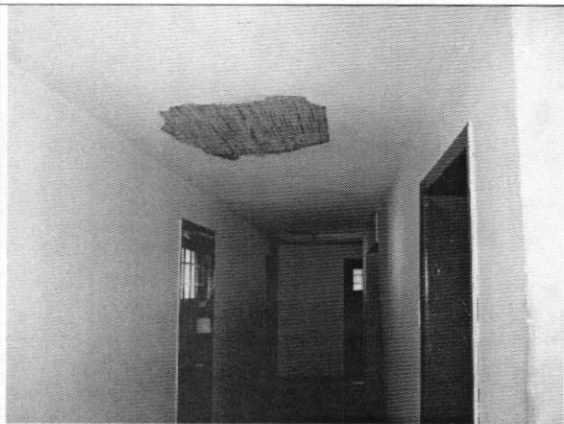
Foto 7. Desprendimiento de pañete del cielo raso
