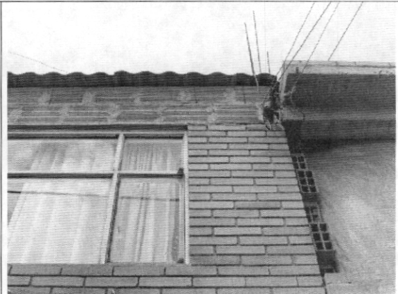
Foto 2. Muro de fachada afectado por agrietamiento
