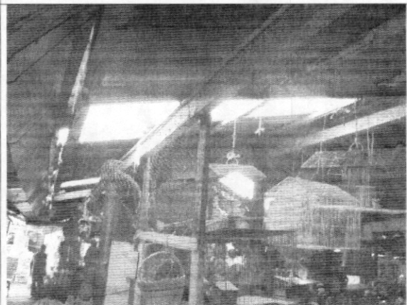
Foto 14. Caída de tejas en la cubierta central
