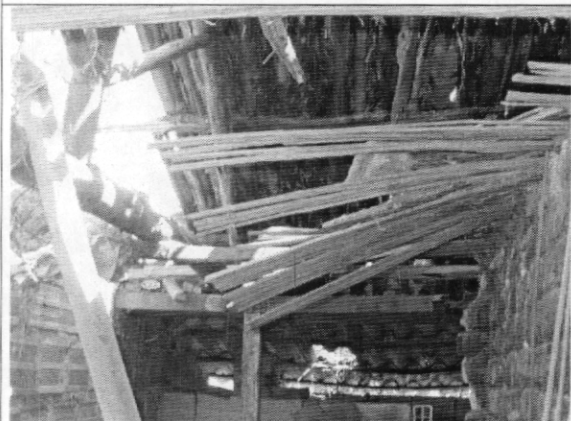
Foto 9. Daños y deterioro en cubierta y cielo raso
