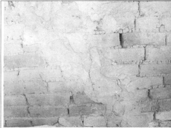
Foto 5. Detalle de los agrietamientos de muros externos
