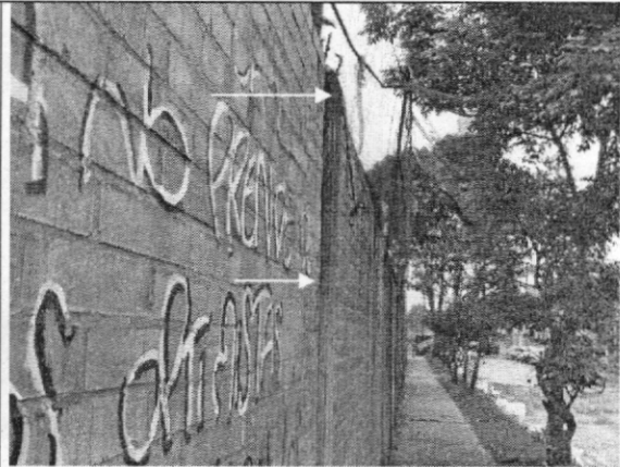
Foto 6. Fuerte pérdida de verticalidad
