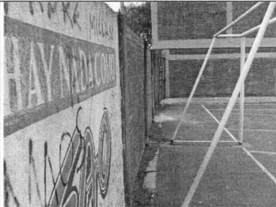
Foto 14. Leve pérdida de verticalidad, costado carrera 69C
