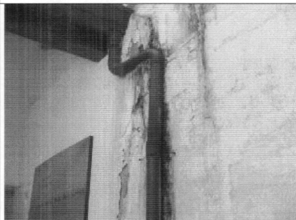
Foto 6. Humedad en zona de bajantes.
