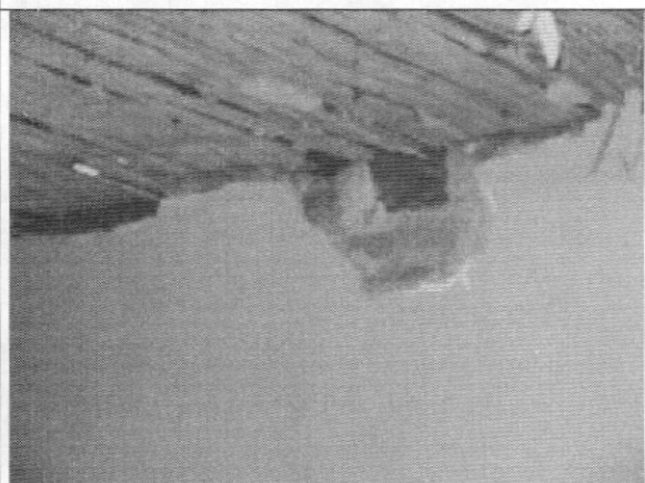
Foto 10. Cielo raso bajo cubierta deteriorado.
