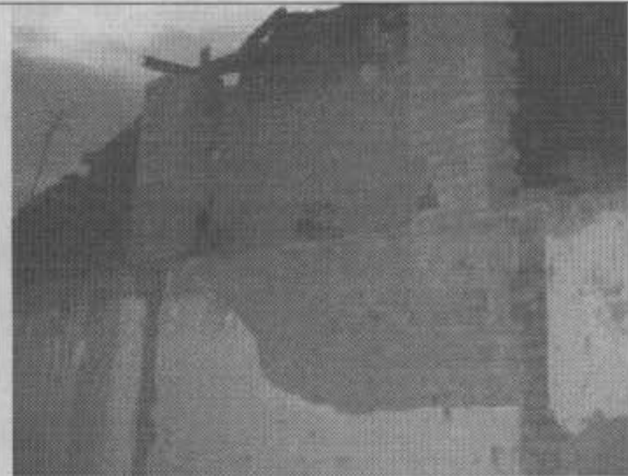
Foto 4. Colapso de muros medianeros.
