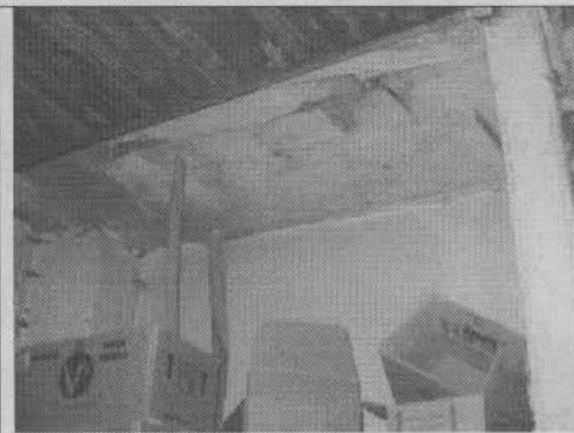
Foto 8. Desprendimiento cielo raso local comercial
