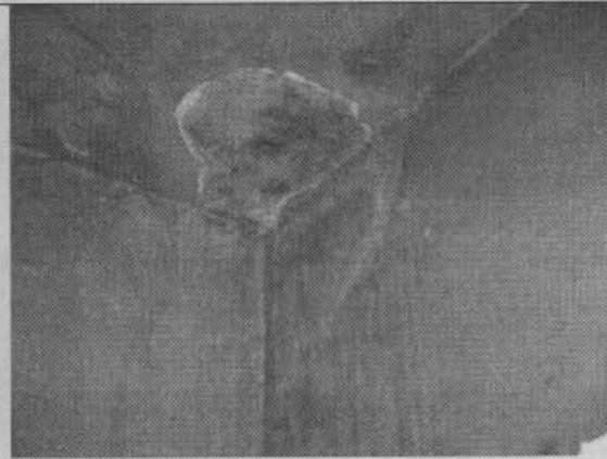
Foto 4. Humedad en muros
