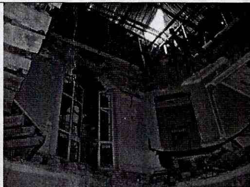
Foto 10. Detalle del segundo piso sin vigas ni entrepiso.
