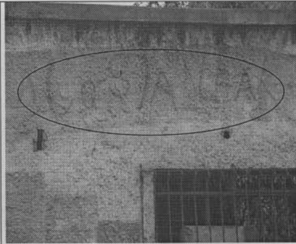
Foto 4. Fisura en parte superior muro.
