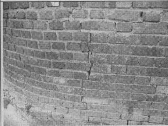
Foto 4. Agrietamientos múltiples y daño fuerte
