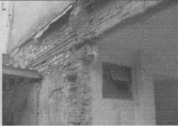
Foto 5. Desprendimiento de unidades de mampostería muros primer piso.
