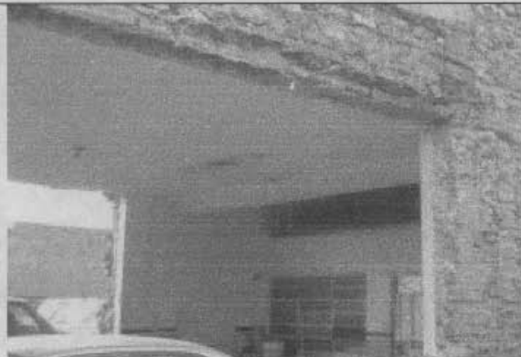
Foto 7. Ejes de vigas no coinciden con ejes de columnas
