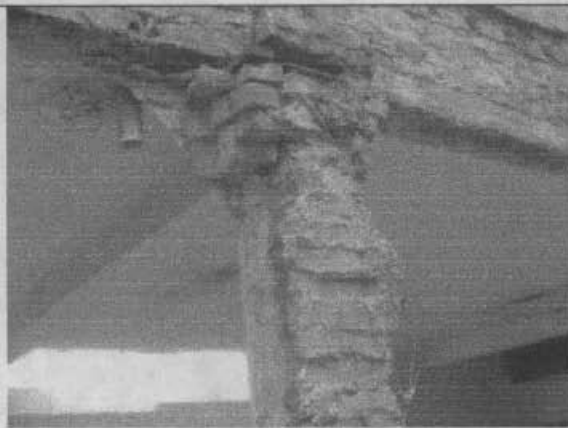
Foto 3. Columnas del primer piso (Refuerzo a la vista y desprendimiento de concreto)
