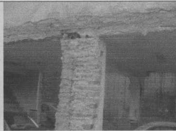
Foto 4. Perdida de verticalidad de columnas de primer piso.
