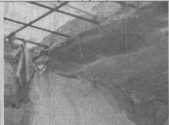
Foto 6. Apoyo deficiente placa maciza
