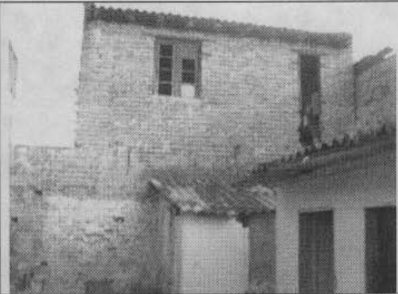
Foto 8. Muro de segundo piso desplomado y sin ningún tipo de confinamiento, edificación C
