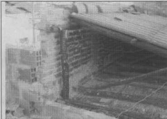
Foto 1. Parapeto sin confinamiento. Estructura de cubierta evidencia deterioro por incendio
