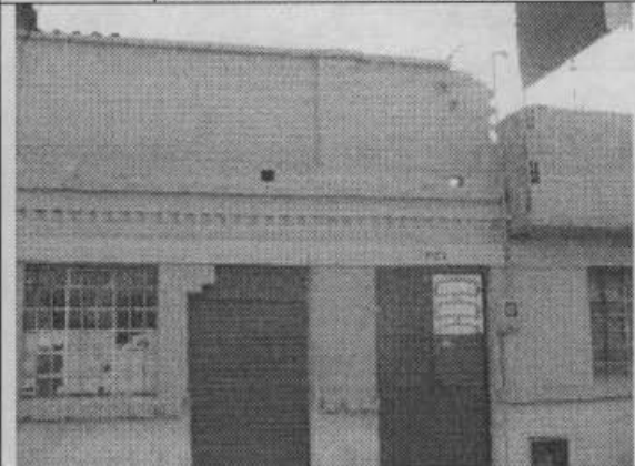
Foto 10. Condiciones de fachada al momento de la visita. Parapeto sin confinamiento
