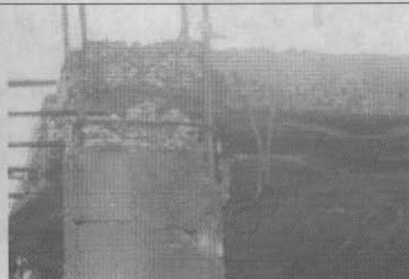
Foto 4. Pérdida de recubrimiento de acero de refuerzo en columnas y nudo apoyo de placa maciza.
