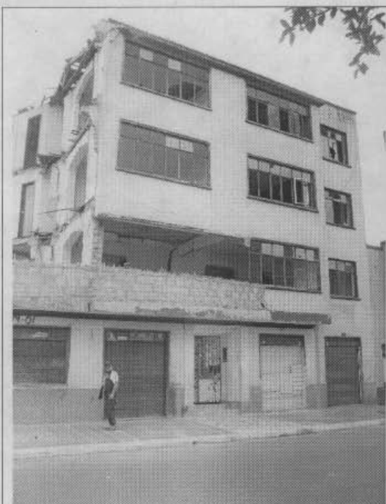
Foto 3. Sector de la edificación sobre la diagonal 22 C; es en esta zona donde se presentan los mayores niveles de daño.
