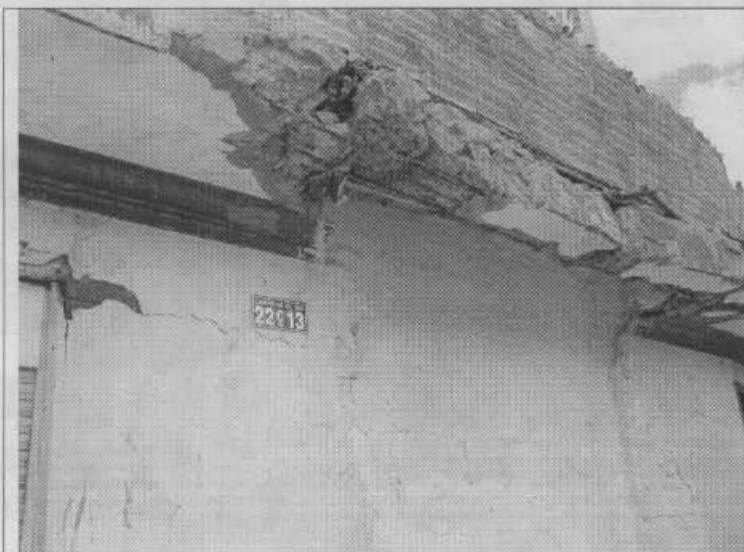
Foto 5. Elementos con posibilidad de caída en placa de voladizo; se advierte agrietamiento en muro del primer piso.
