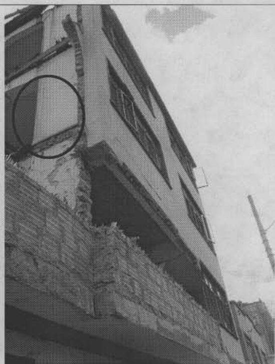
Foto 4. Se indica muro portante localizado en el segundo piso en el que se advierten agrietamientos.
