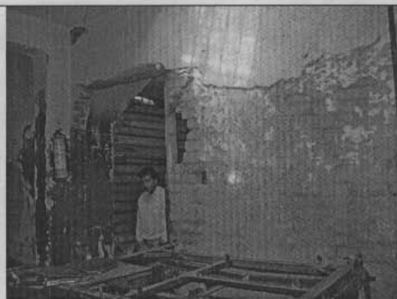
Foto 6. Muro de adobe del primer piso; presenta agrietamiento y dislocación de las unidades de adobe.
