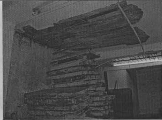
Foto 2. Sector del primer piso; se aprecia desprendimiento del acabado del cielo raso dejando en evidencia humedad a nivel de cubierta.
