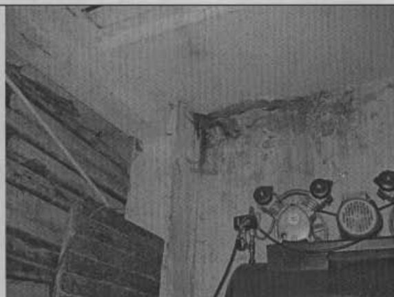
Foto 6. Humedad en muros del primer piso proveniente de la cubierta.
