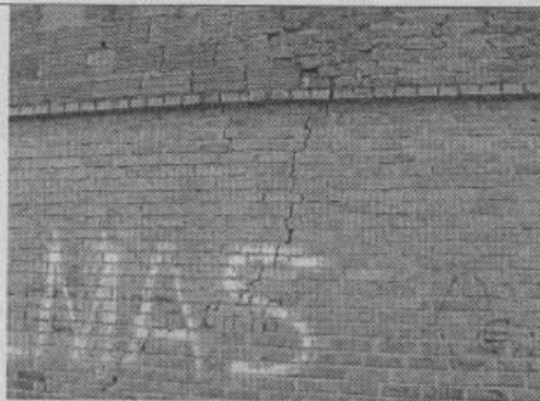
Foto 4. Vista del muro con grietas.
