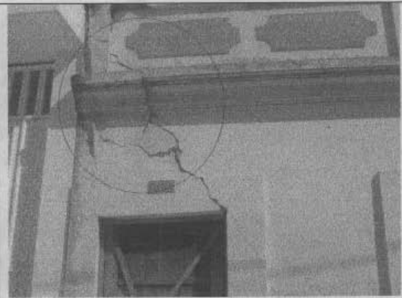
Foto 2. Muro de fachada agrietado.
