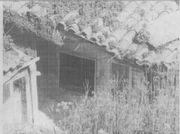
Foto 8. Muros deteriorados. Invasión de vegetación al interior de la edificación.
