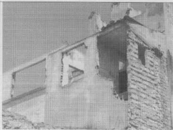
Foto 9. Muros de la edificación sin amarre a la estructura, desprendimiento de unidades de mampostería.
