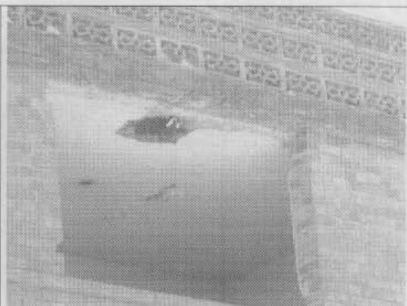
Foto 2. Deterioro de los muros de fachada.
