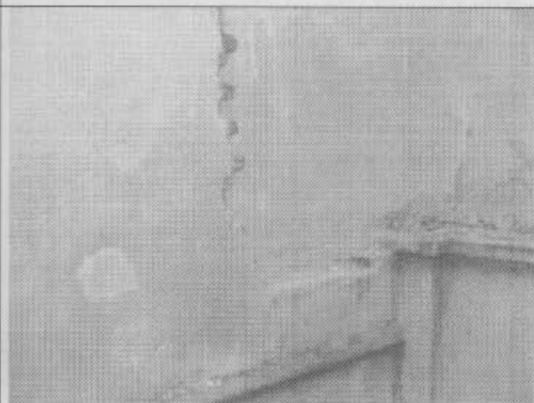
Foto 8. Desprendimiento de acabados muros interiores zona patio.
