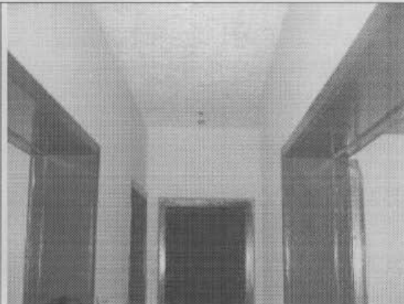
Foto 6 Muros cuarto piso y cielo raso bajo cubierta.
