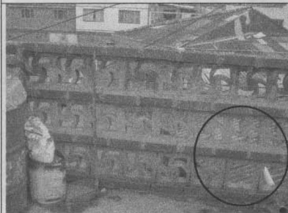
Foto 3. Celosía en cemento deteriorada.
