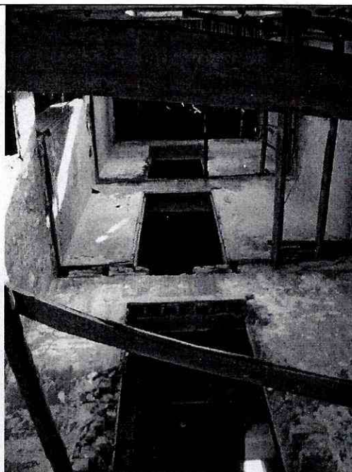
Foto 2. Detalle desprendimiento de entrepisos y de acabados de muros.
