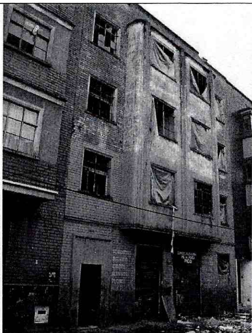
Foto 1. Fachada de la edificación en las condiciones presentes al momento de la visita. Desprendimiento de acabados.
