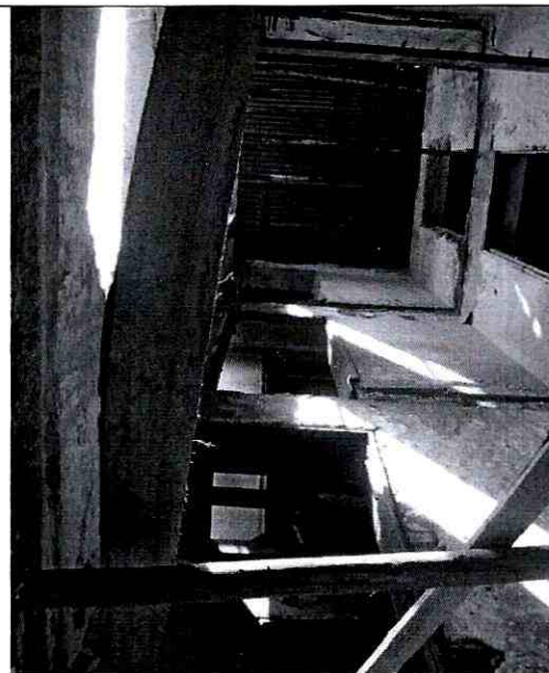
Foto 6. Vista interior falta total de los entre pisos.
