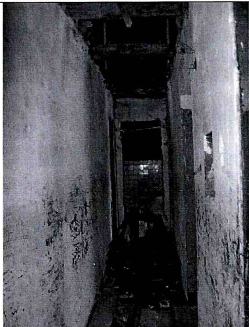
Foto 3. Desprendimiento de acabados en muros al interior del inmueble.
