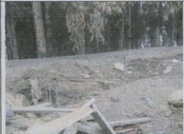
Foto 6. Escombros contra muro de mampostería de aproximadamente 2.50 metros de altura
