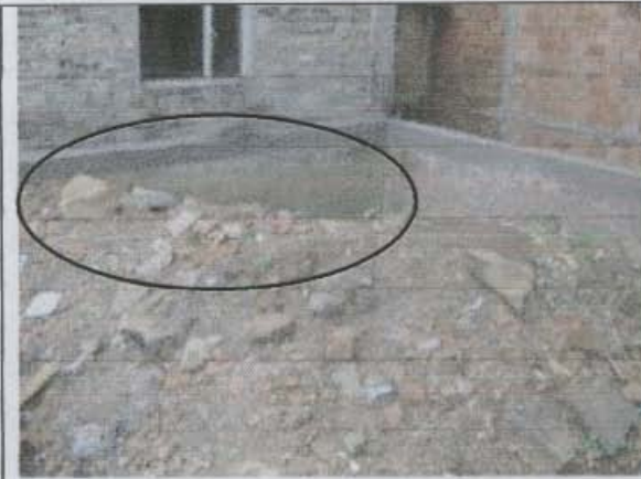
Foto 3. Relleno de material de escombros contra muro de la vivienda.
