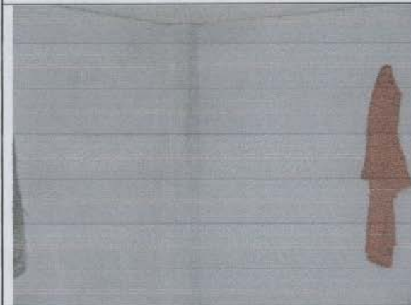
Foto 5. Humedad en los muros de la estructura
