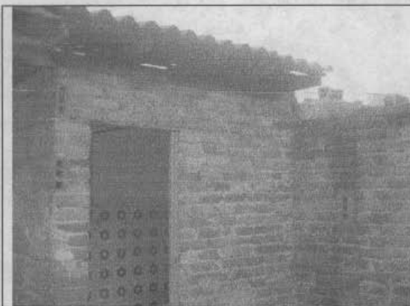
Foto 5. Muros de soporte de la cubierta en mal estado
