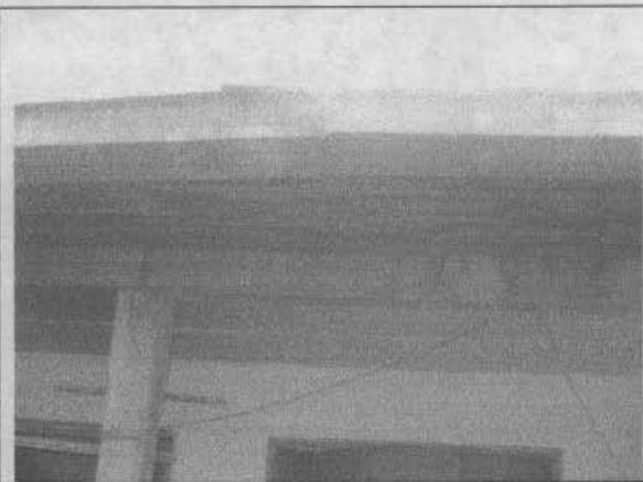
Foto 6. Estructura de cubierta en malas condiciones
