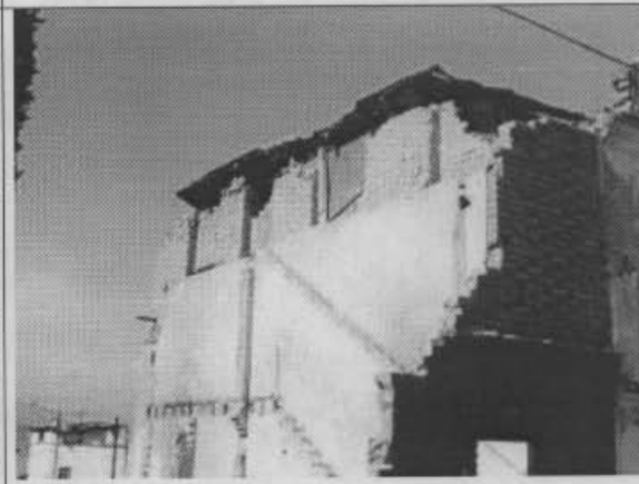
Foto 4. Colapsos parciales y agrietamientos del muro por la culata del costado occidental, lo cual ha generado alta vulnerabilidad de la construcción.
