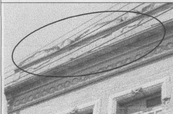
Foto 3. Detalle desprendimiento de acabados en muros de fachada.
