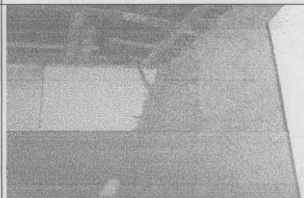
Foto 4. Colapso del cielo raso en algunos sectores de la construcción a nivel de segundo piso.
