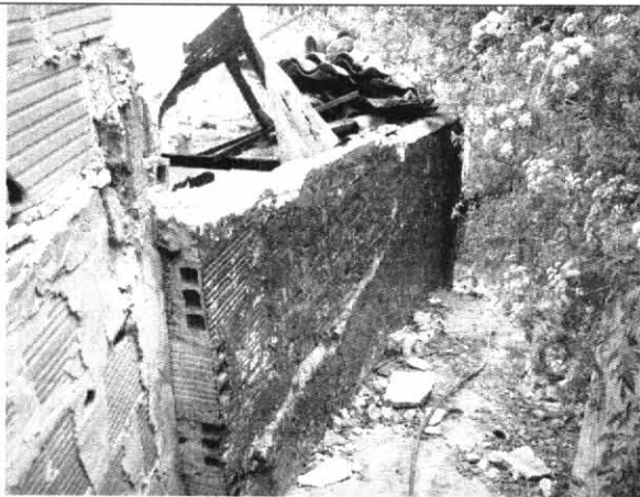
Foto 3. Deterioro de muros y cubierta
