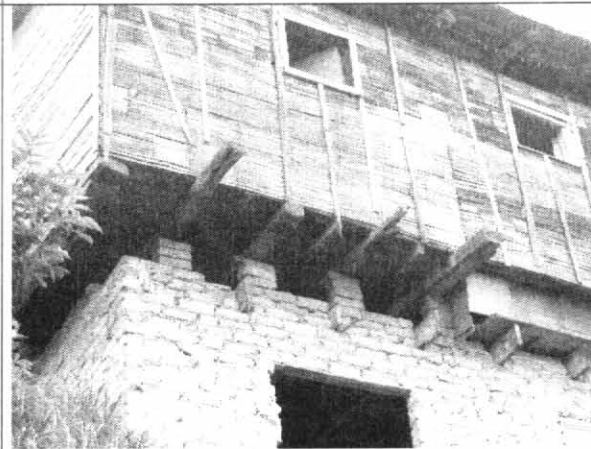
Foto 6. Apoyos inadecuados de los elementos de entrepiso
