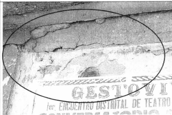
Foto 4. Agrietamiento severo del muro fachada.
