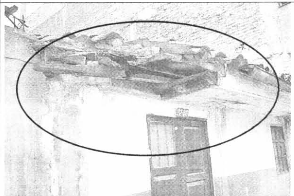
Foto 4. Se identificó que la estructura de cubierta esta parcialmente colapsada hacia el costado sur del inmueble.
