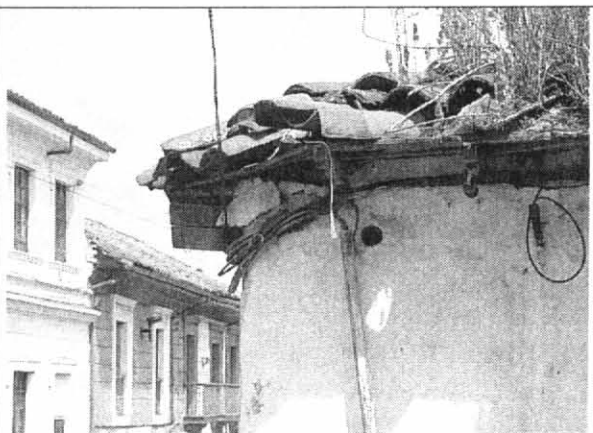
Foto 4. Hay caída de tejas y riesgo de afectación a transeúntes.
