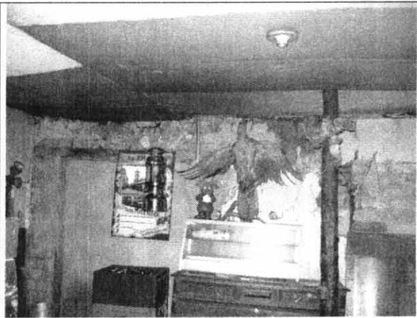
Foto 8. Muros internos sin daños apreciables.
