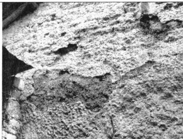
Foto 5. Desprendimiento de fragmentos del acabado.
