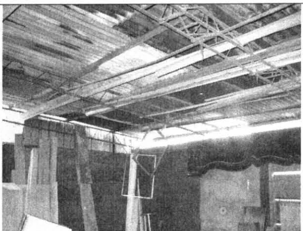
Foto 12. Elementos de cubierta del sector anterior con deficiencias en los amarres de elementos.
