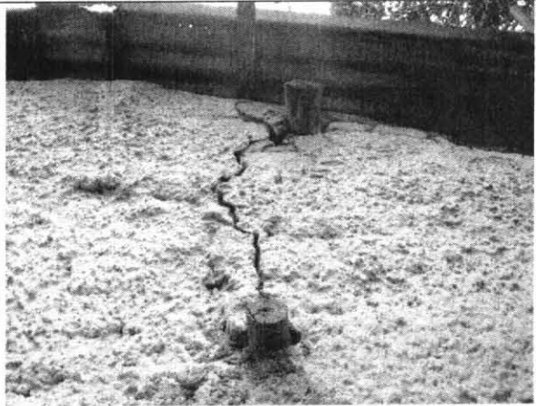
Foto 4. Fisuras del pañete de recubrimiento del muro.
