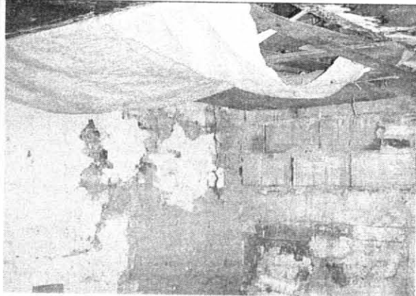
Foto 4. La estructura de cubierta esta parcialmente colapsada y no hay un arriostramiento adecuado que garantice integralidad estructural.
