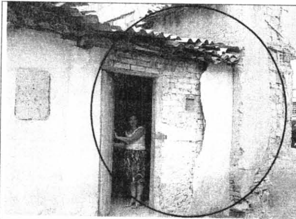
Foto 1. Condiciones de fachada al momento de la visita, desprendimiento de acabados y deterioro progresivo.
