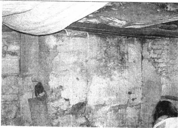
Foto 3. Al interior del inmueble la estructura esta deteriorada y los muros están agrietados.
